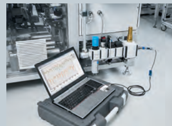
Wykrywanie i eliminacja nieszczelności
