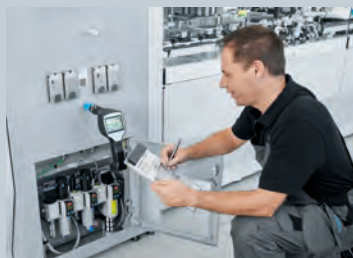
Kompleksowy Audyt Efektywności Pneumatyki
